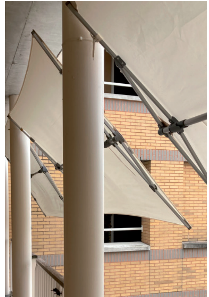
zonwering niet overal toegestaan door architect
